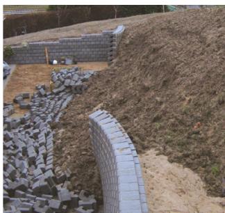
Eksempel på kollapsed mur. Muren er kollapsed fordi der ikke i opbygningen er taget hensyn til den forøgede jordlast fra skrånningen bag muren.
